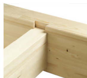
Viga desviada em suporte
